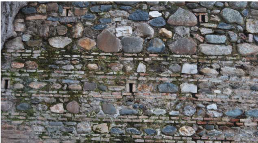
15 Alhambra. Las gargolas enrasadas al muro de contención permite evacuar los excedentes del agua del terreno que contiene.
